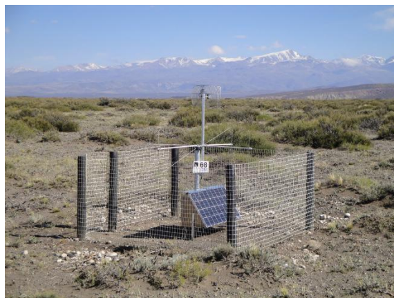
Figura 8. Estación de AERA.
